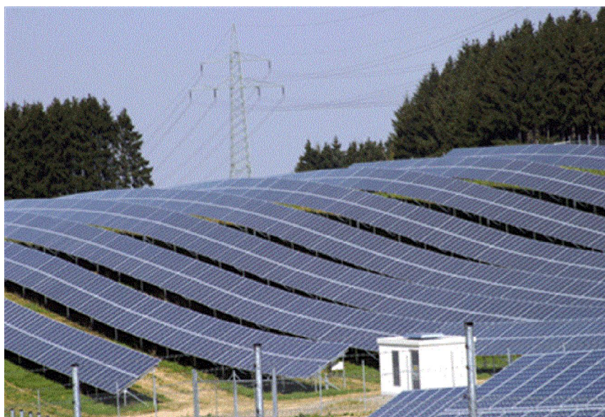
ภาพโรงไฟฟ้าพลังงานแสงอาทิตย์ จังหวัดลพบุรี
