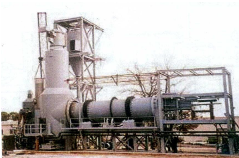
ภาพที่ 6.6 ระบบเตาเผาแบบหมุนที่ติดตั้งใช้งานจริง
